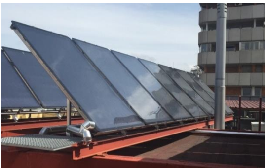
Instalación energía solar térmica para ACS
