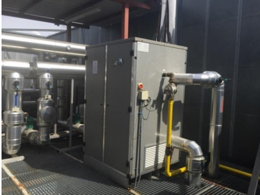
Equipo "Roof top" de producción de ACS y calefacción
