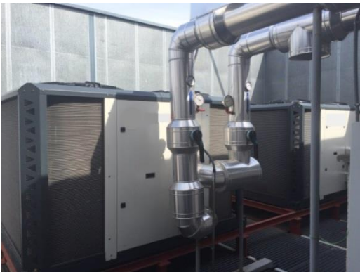
Enfriadoras de agua de condensación por aire
