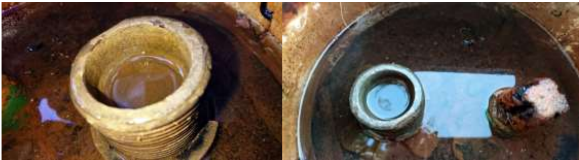
Boca de incendio actual en el barrio de Carrascal
