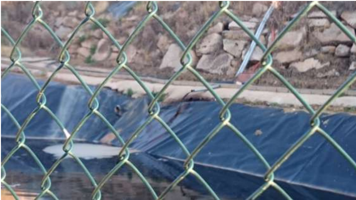
Tubería expulsando lixiviados y nivel de la balsa
